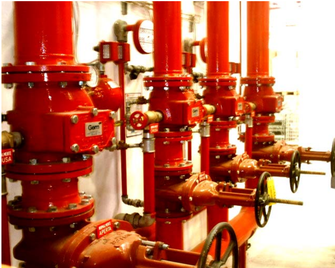
(Particolare di stazioni automatiche impianti sprinkler)
