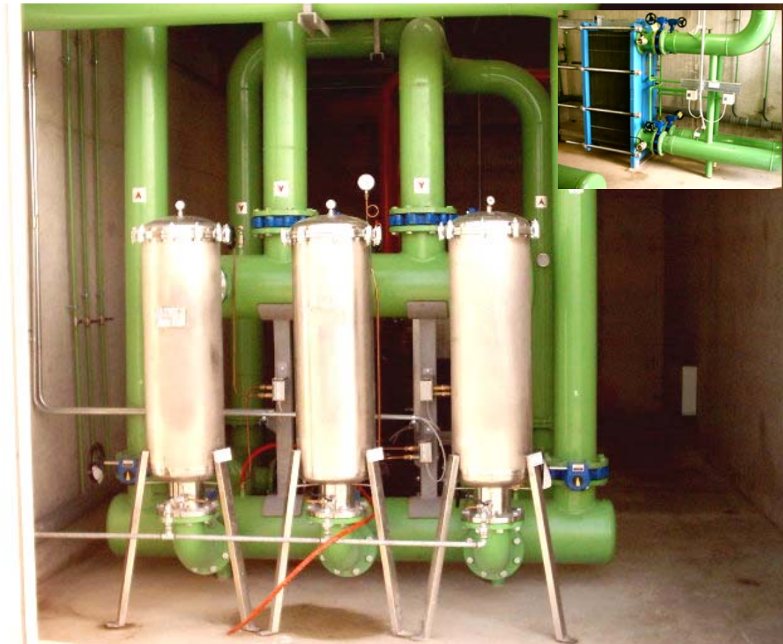
(Impianto di filtraggio acqua di torre e particolare scambiatore acqua di torre – acqua di processo)
