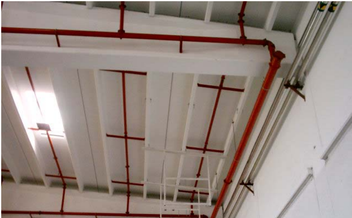
(Particolare impianto sprinkler ESFR)
