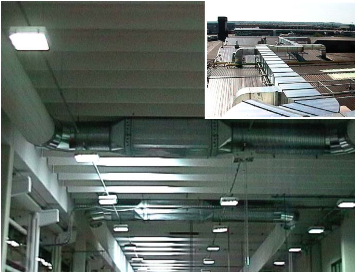
(Impianto di condizionamento eseguito con canali tessili e particolare distribuzione aria in copertura)
